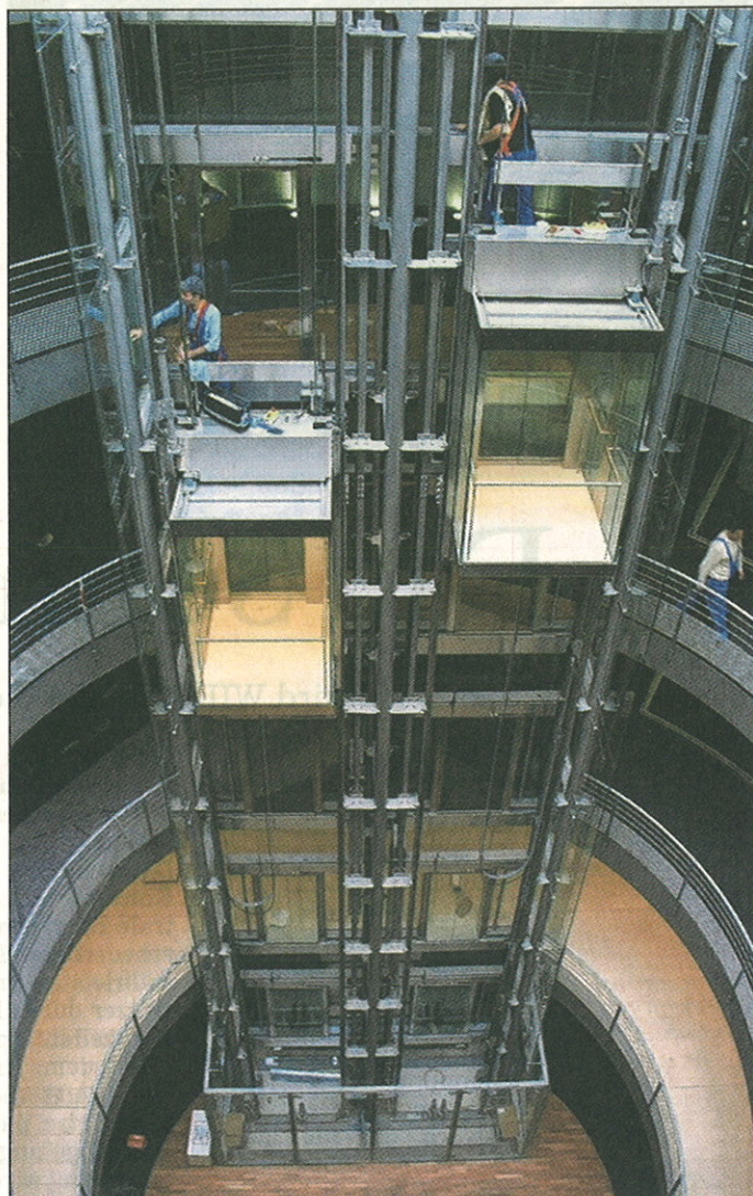
Die Mitarbeiter der Firma Hauck bei ihrer Spezialreinigung der Aufzüge in der neuen SAP-Deutschlandzentrale. Bild: privat
